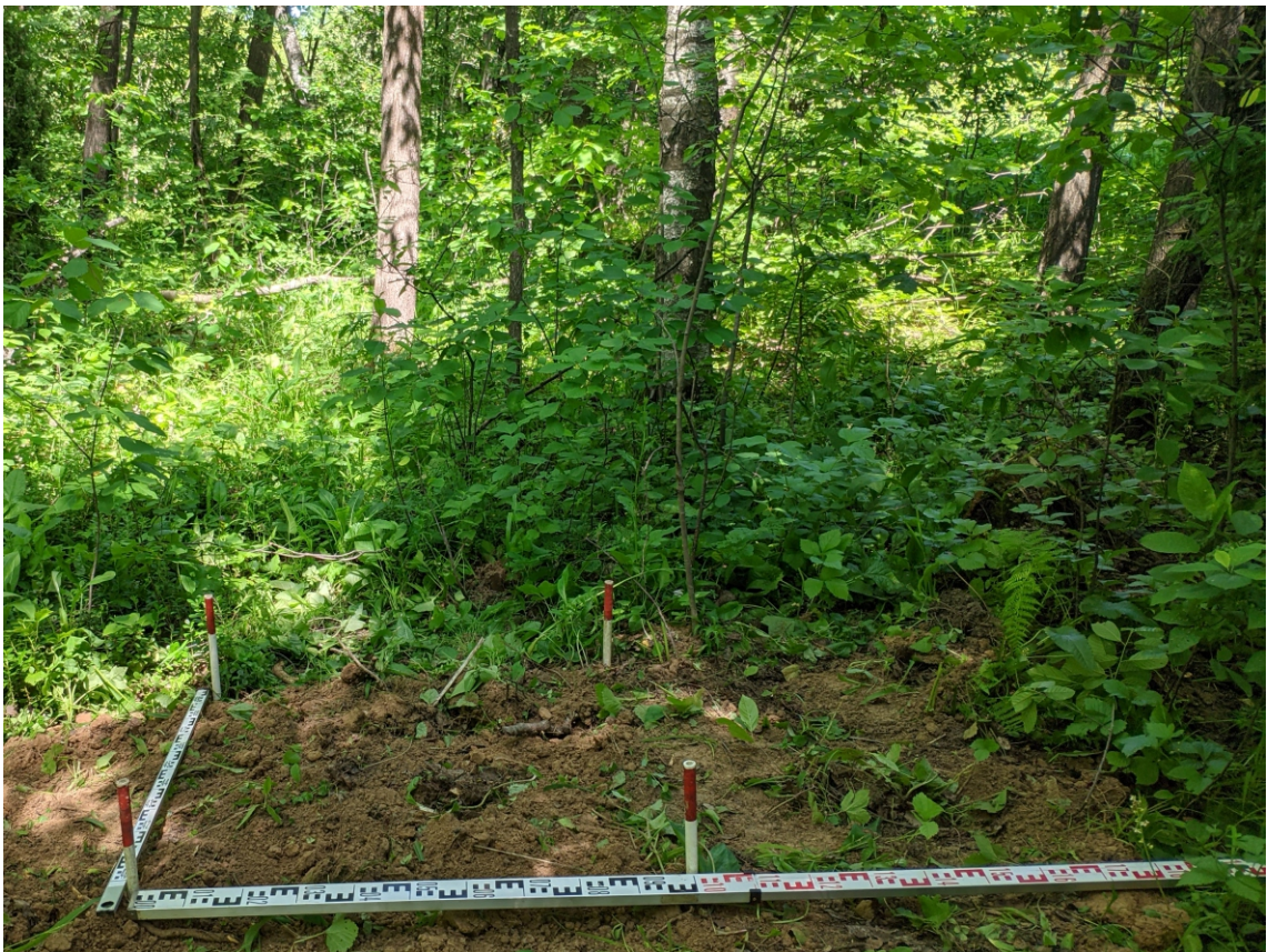
Рис. 26. Калужская область, г. Обнинск. «Реконструкция участка автодороги по улице Северная (от транспортной развязки «Северный въезд» до железной дороги) в городе Обнинске». Поверхность шурфа-2 после засыпки и рекультивации. Вид с юга.
